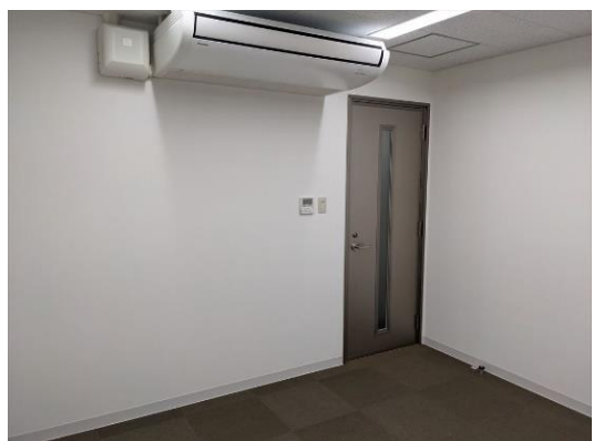
サーバールーム
